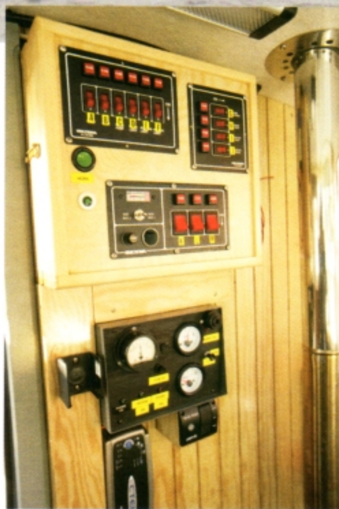
ELEKTRONIKK: Det elektriske anlegget om bord er vakkert utført.
